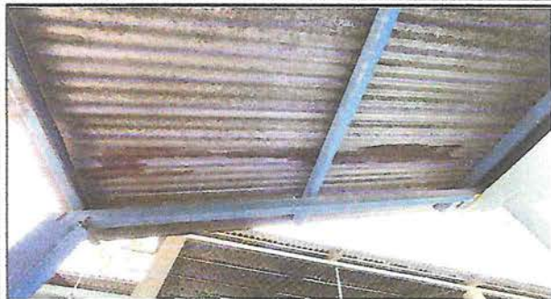
Foto 1: Lámina de aula en mal estado
