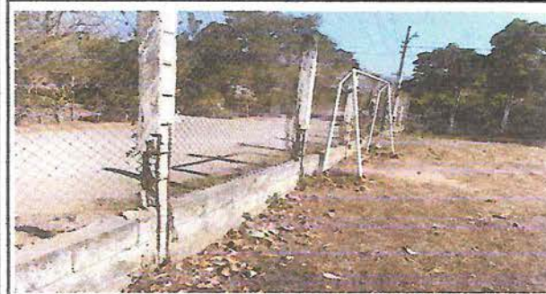
Foto 3: Columna del área de circulación en mala condiciones
