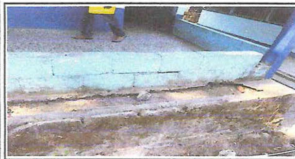
Foto 5: Cimiento y piso en mal estado
