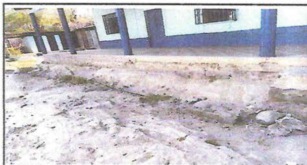
Foto 6: Banqueta en mal estado
