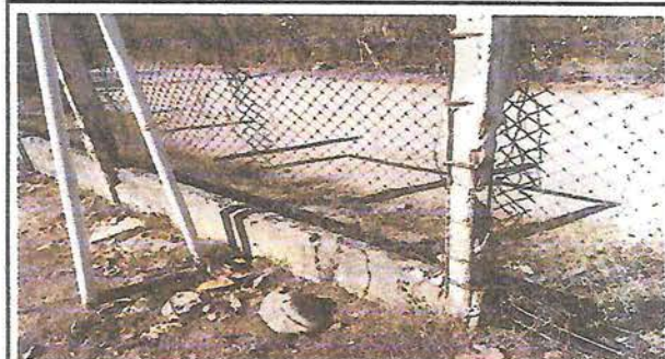
Foto 4: Malla y columnas en mal estado
